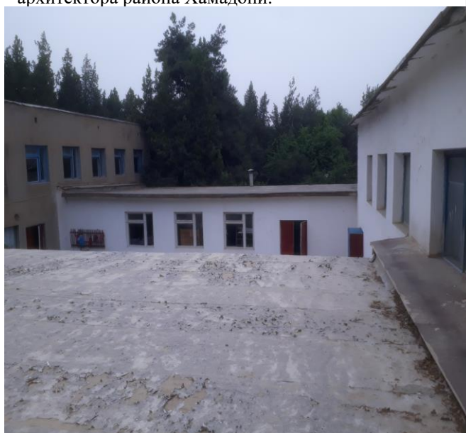
Фото: Состояние кровли учебных корпусов сверху
