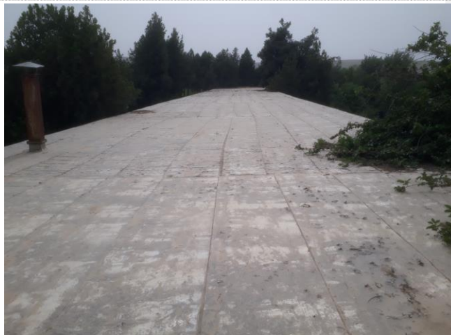
Фото: Состояние крыши учебных корпусов сверху
