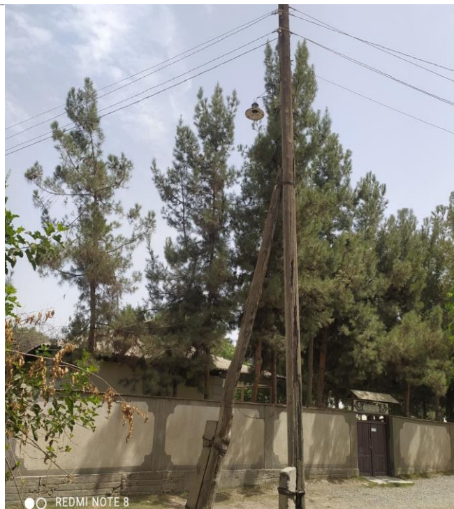
Фото: Состояние опра
