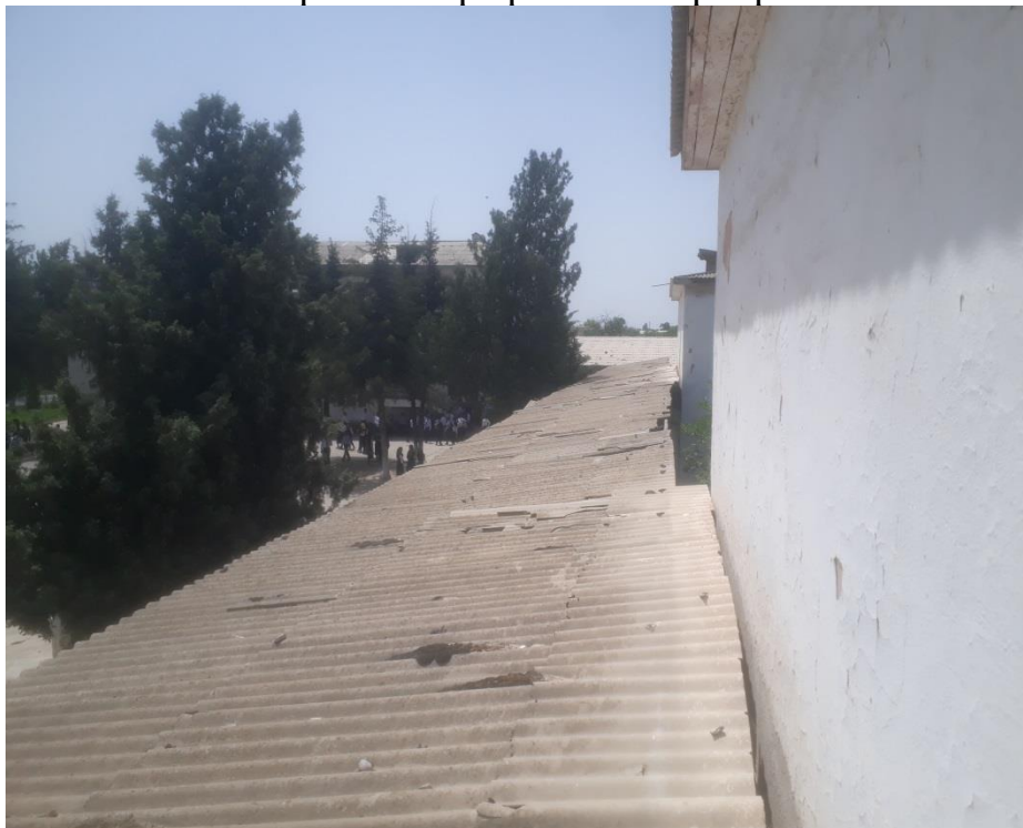
Фото: Состояние кровли учебных корпусов сверху
