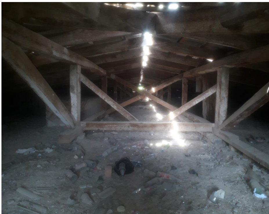
Фото: Состояние крыша учебных корпусов внутри
