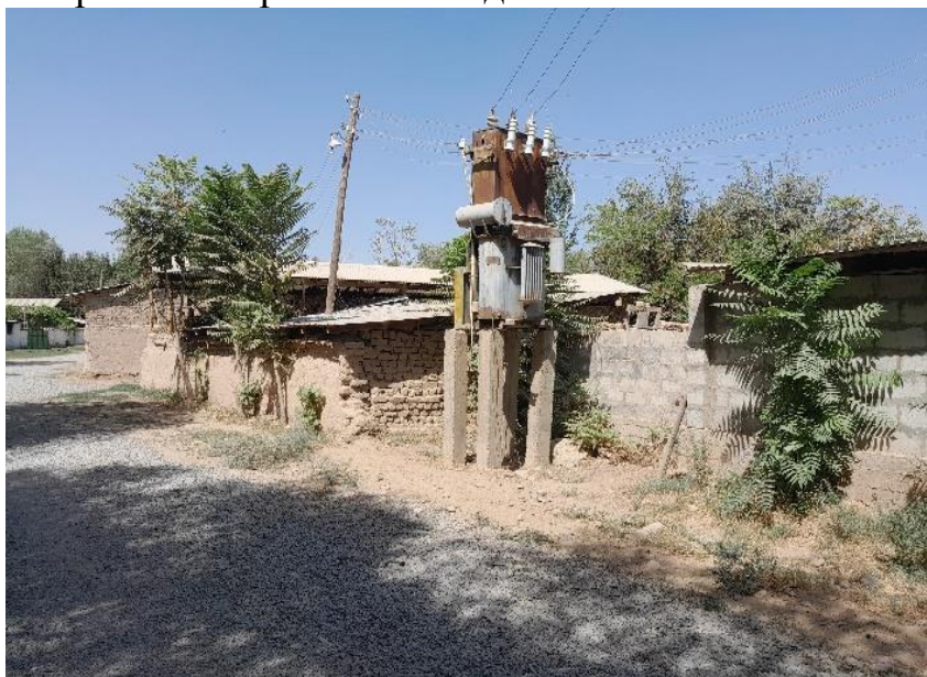
Фото: Состояние опор
