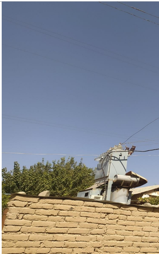
Фото: Состояние трансформатора
