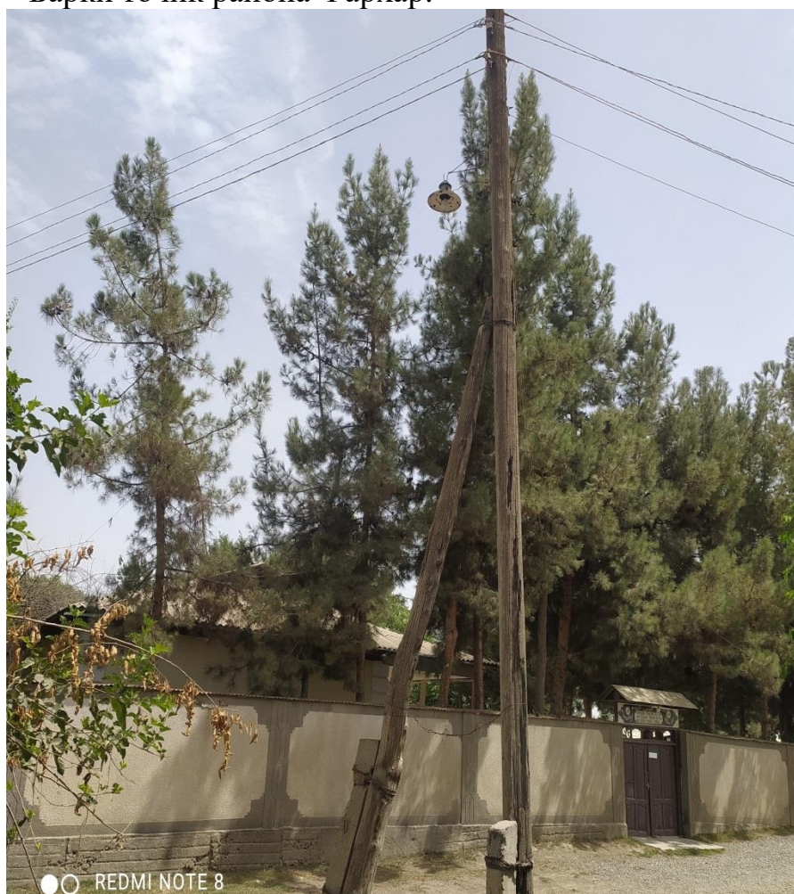
Фото: Состояние опра
