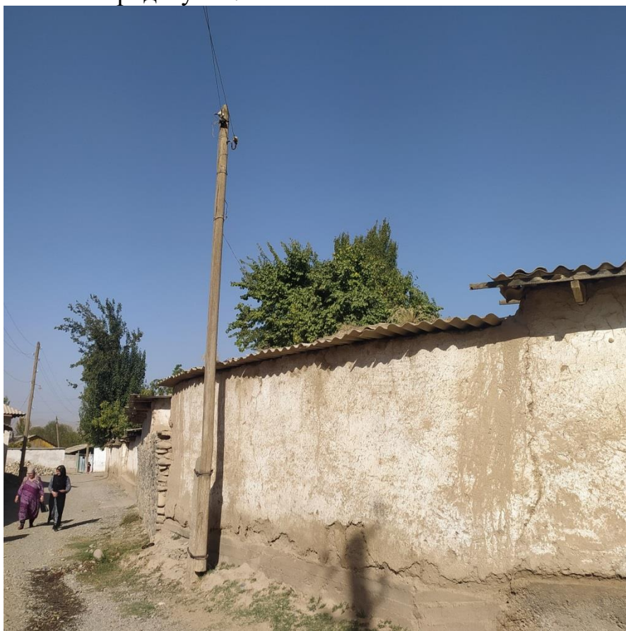
Фото: Состояние опра
