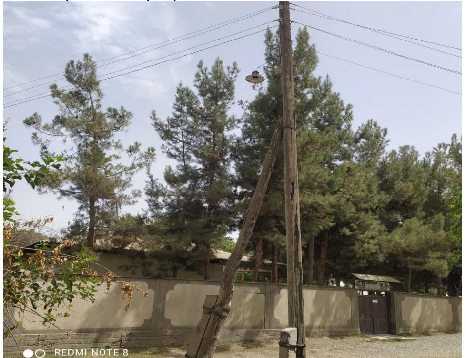
Фото: Состояние опра
