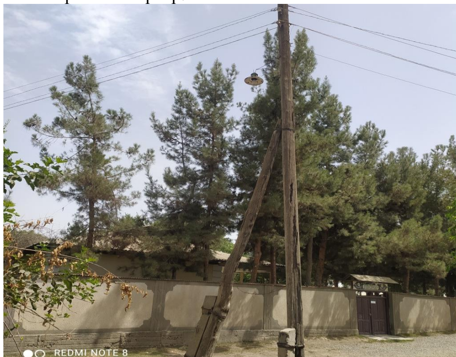
Фото: Состояние опра
