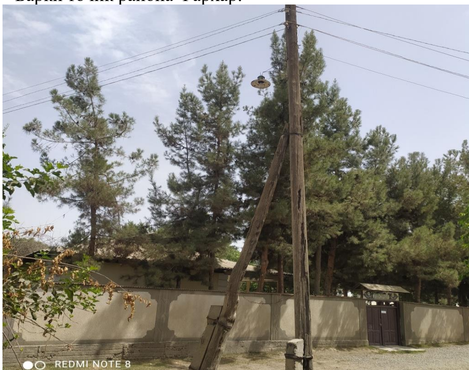
Фото: Состояние опра
